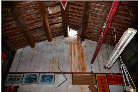
後落九架木構架、屋頂破洞
