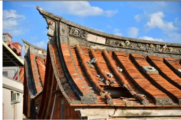
前落左房屋頂破損
