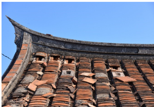
圖33 屋頂因颱風瓦片毀損
