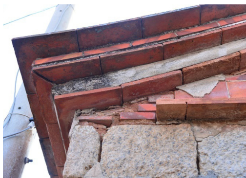
圖31 後側鳥踏與檐版損壞
