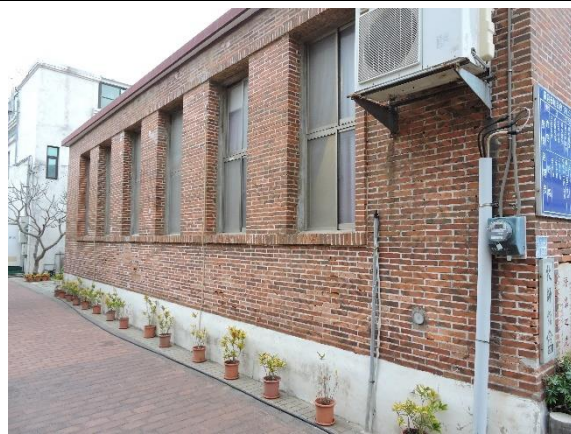
【照片 2-14】禮拜堂西向磚面及勾縫風化、油漆剝落、牆面洗孔、植物竄根
