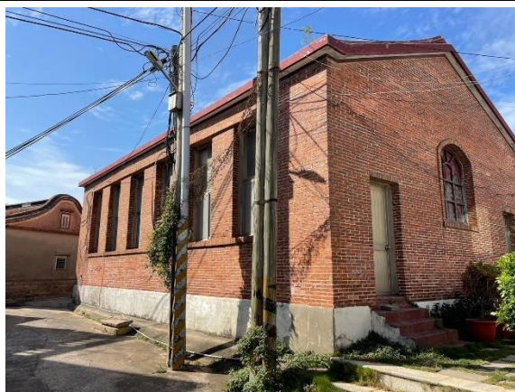
【照片 2-13】禮拜堂東向磚面及勾縫風化、牆面洗孔、植物竄根、粉刷層開裂
