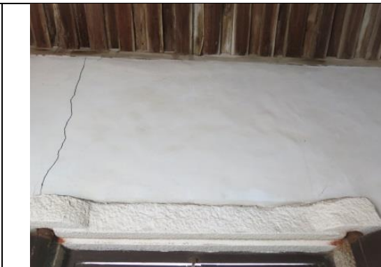
圖 2-3-4 前廳門扇上方牆身裂痕
