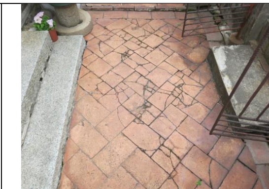
圖 2-3-8 外埕出入口處尺二磚地坪龜裂破損
