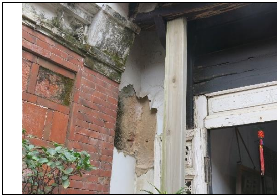
圖 2-3-17 擗頭與前落交接處牆體嚴重剝落
