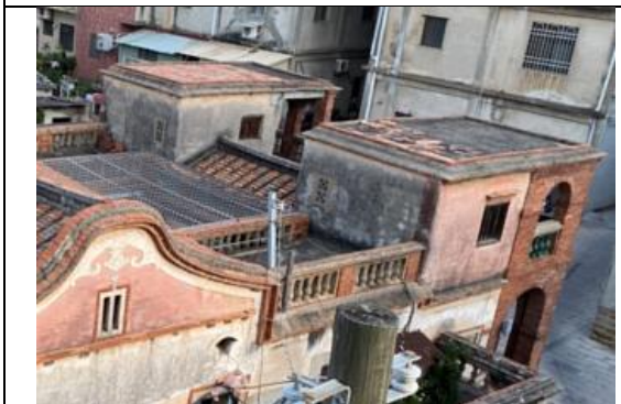
圖 2-3-27 疊樓屋面尺磚部份佚失
