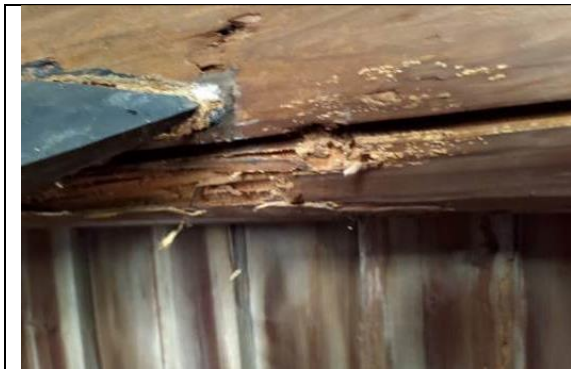
圖 2-3-19 後廳屋桁遭白蟻嚴重蛀蝕及龜裂嚴重
