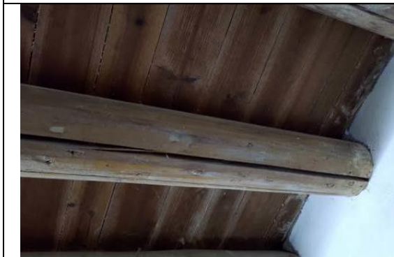
圖 2-3-21 倉庫木桁有蟻道、樑身嚴重龜裂
