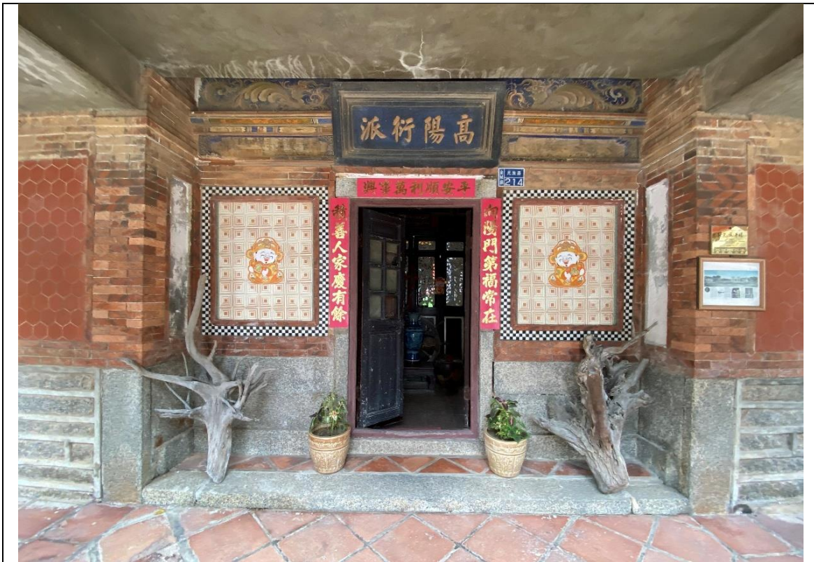
五腳基廊道入口處修復前
