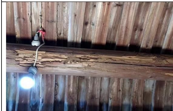
圖 2-3-23 前廳木桁遭白蟻嚴重蛀蝕
