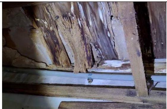
圖 2-3-24 右擗頭臥室遭白蟻嚴重蛀蝕
