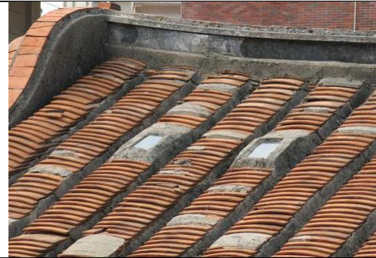
圖 2-3-26 後落屋面屋瓦風化、破損、佚失
