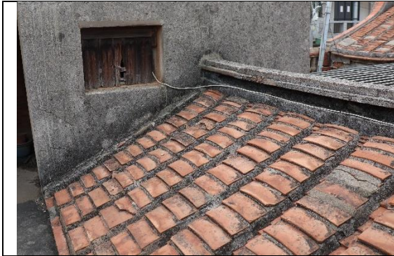
圖 2-3-25 前落屋面屋瓦風化、破損、佚失
