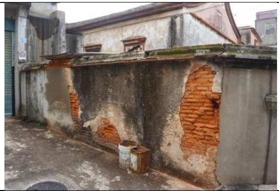
圖 2-3-18 外層蚵殼灰粉刷層剝落
