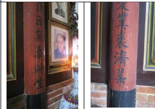
圖 2-3-6 後廳柱身龜裂
