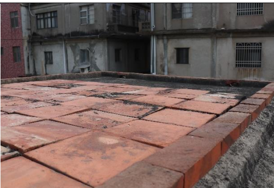
圖 2-3-28 疊樓磚坪屋面風化、部份佚失
