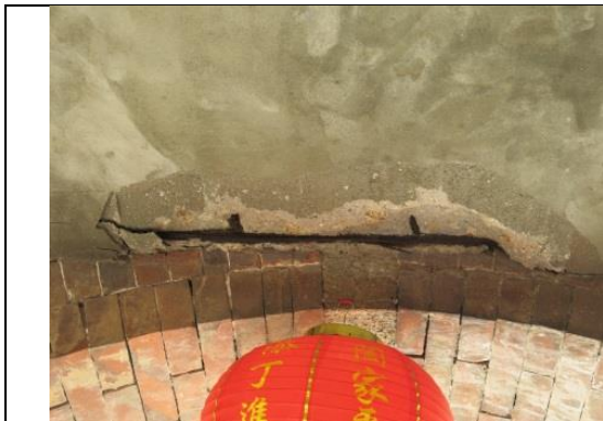
圖 2-3-3 五腳基 RC 樓板破損，鋼筋裸露
