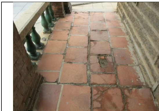
圖 2-3-7 五腳基廊道尺二磚地坪龜裂破損
