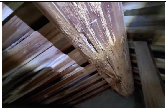
圖 2-3-22 巷頭半樓屋桁遭白蟻嚴重蛀蝕
