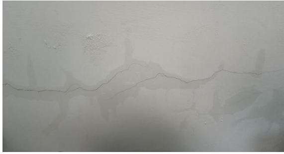
圖 7 二樓壁體龜裂且有滲水現象
