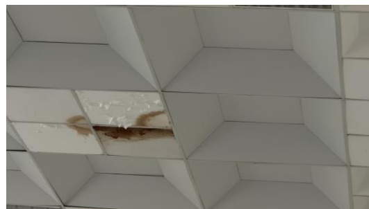
圖 4 博物館屋頂在強降雨漏水後留下水漬
