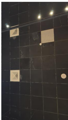
圖 3 博物館屋頂遇強降雨仍有漏水情事
