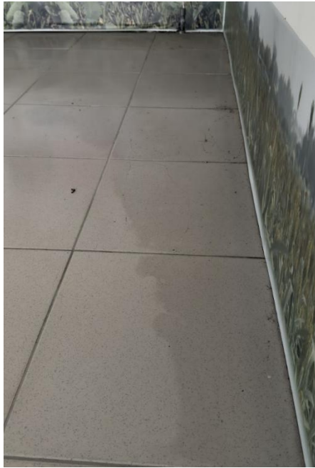
圖 9 三樓室內地坪在強降雨後有積水情事
