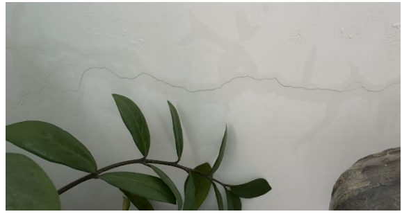
圖 8 二樓壁體龜裂且有滲水現象
