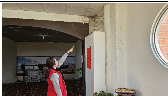
圖 4 館方人員協助指認二樓漏水位置
