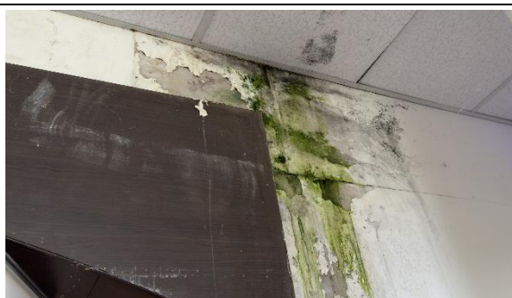
圖 3 二樓漏水，造成壁體出現霉斑
