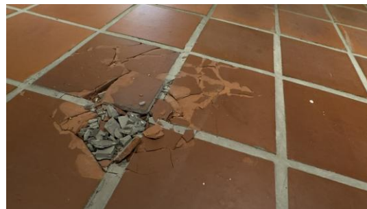
圖 6 博物館地坪破損
