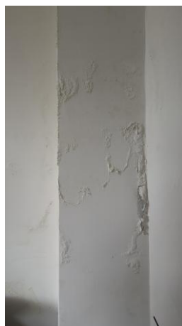
圖 4 文化館壁體因濕氣等因素造成剝落情事，需要改善
